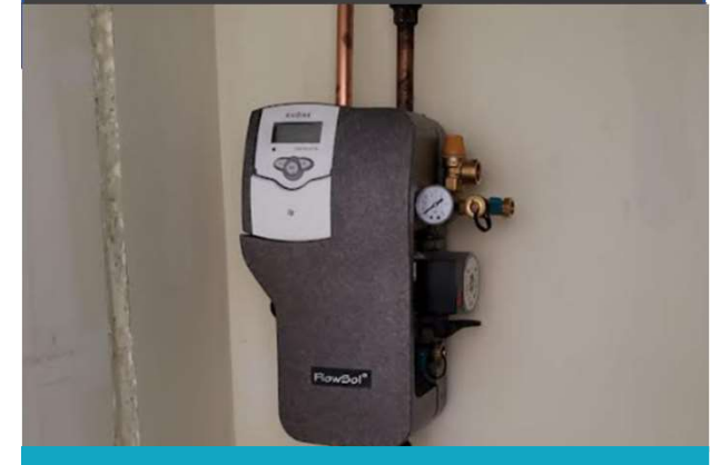
GRUPO BOMBEO SOLAR
